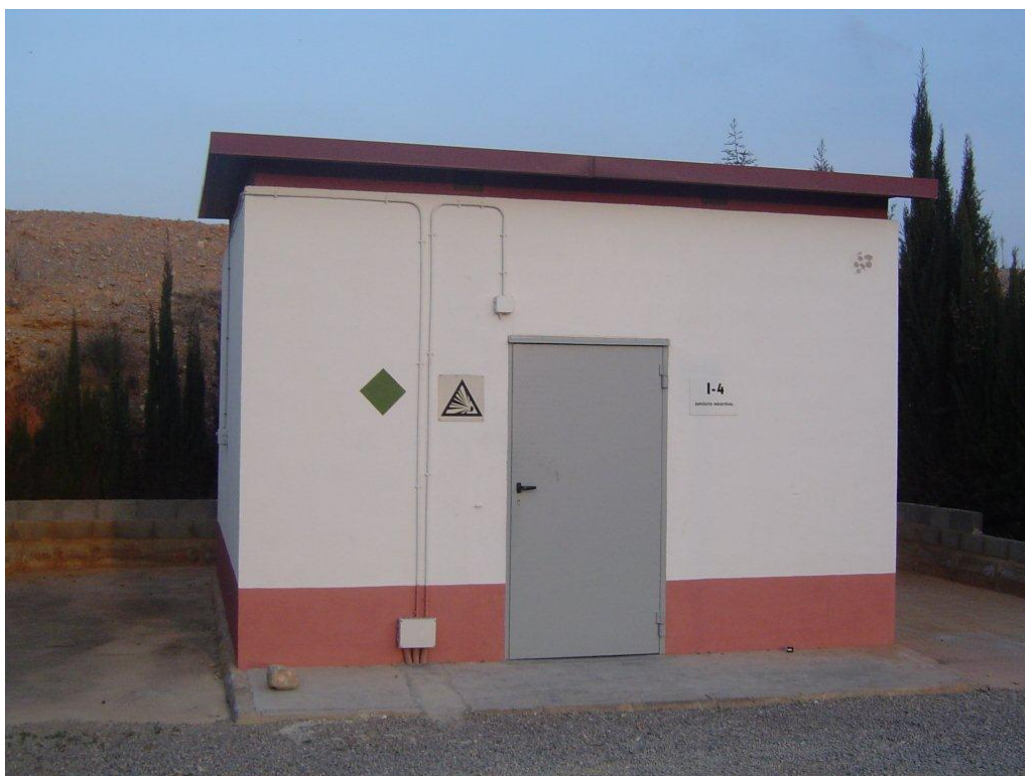
Ilustración 17: Instalación eléctrica exterior 2
