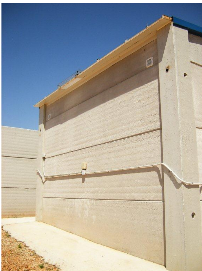
Ilustración 16: Instalación eléctrica exterior 1
